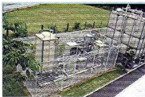
【地下水膜ろ過システム
