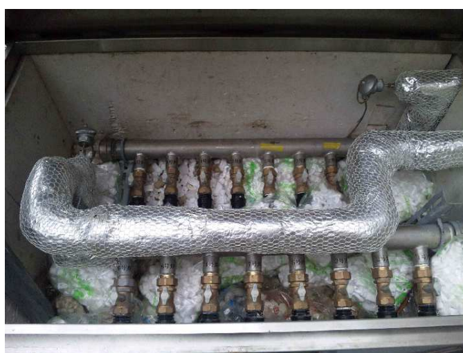
写真 3 駐車場脇に設置された熱源水管ボックスの内部
